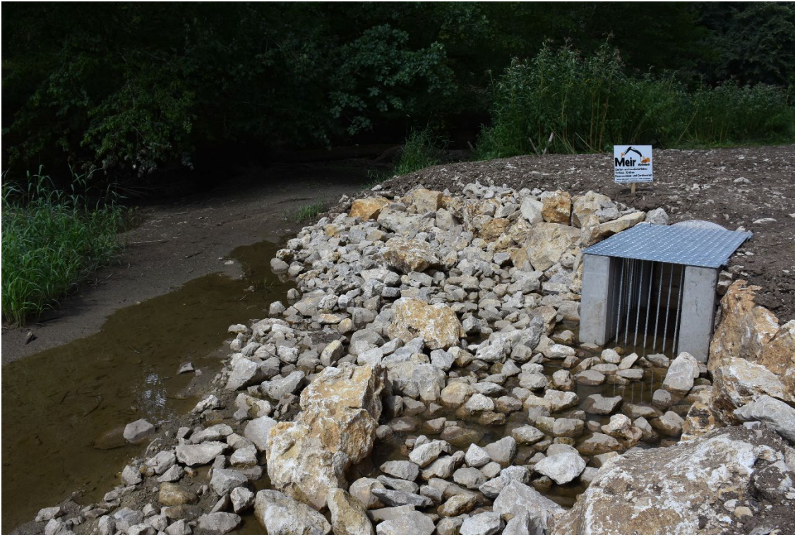
Bildunterschrift: Der neu installierte „Bibermönch“ im Möhrenbachtal bei Gundelsheim. Bildnachweis: Landratsamt Weißenburg-Gunzenhausen / Nico Kögel
